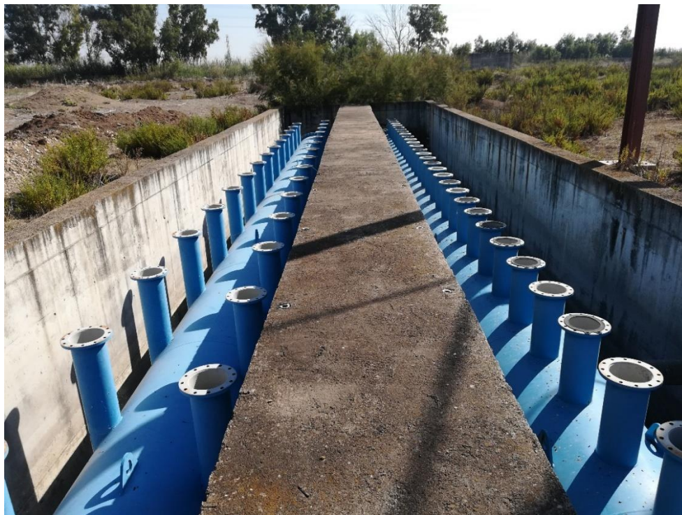
Imagen 20. Vista general de la estación de filtrado.
