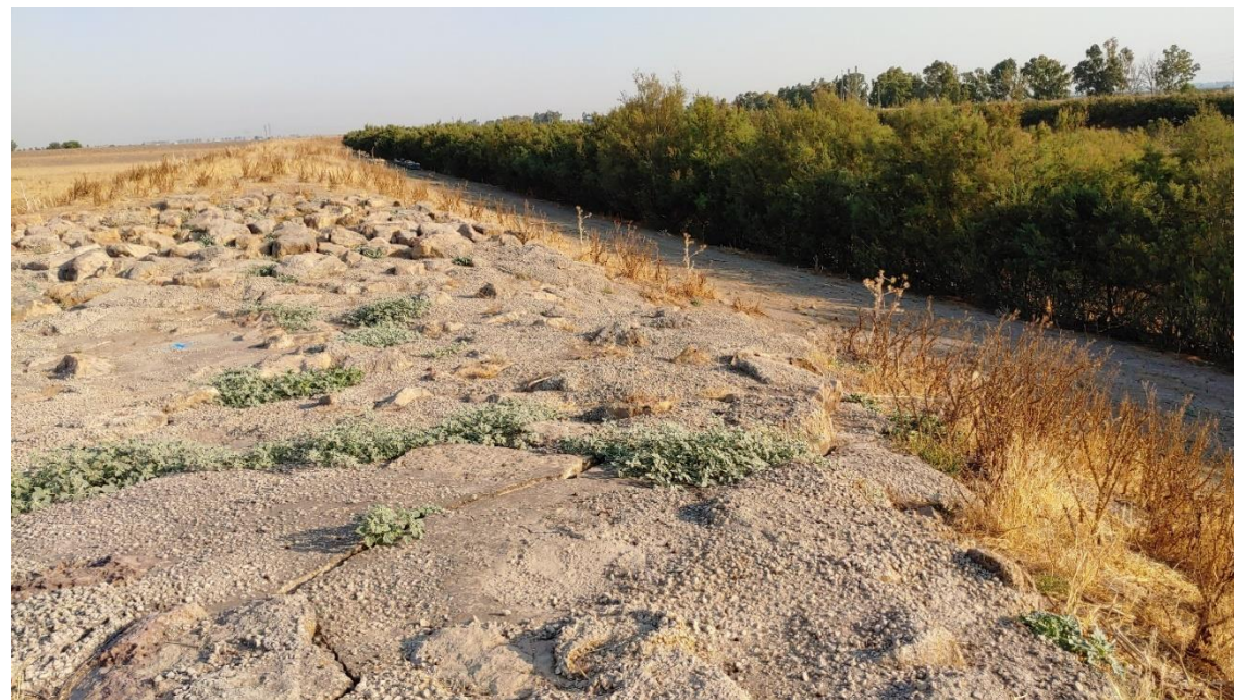
Figura 16. Estado actual de la Balsa de Decantación (1)
