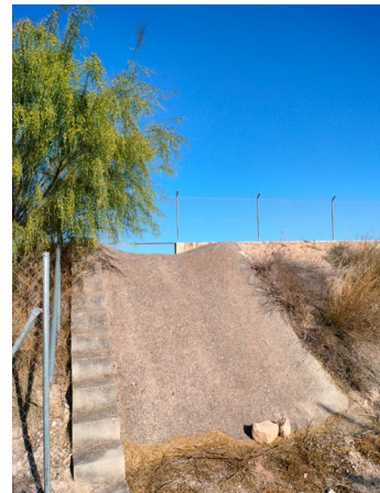
En esta imagen se visualiza el aliviadero existente, se demolerá y renovará la parte horizontal, y se mantendrá la parte del talud (al estar en buen estado).
