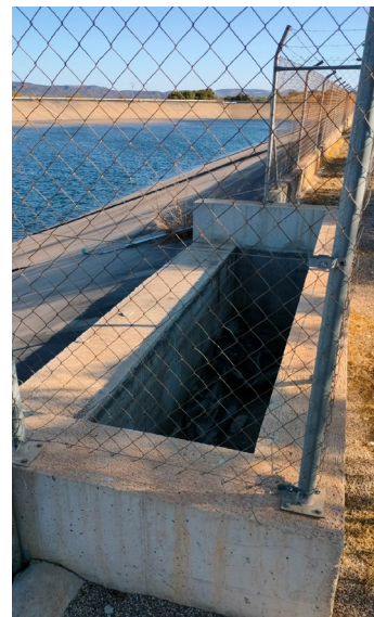
En esta imagen se visualiza la arqueta de rotura de la entrada de agua procedente del TTS, se realizará la adaptación de esta arqueta con la lámina nueva a instalar.
