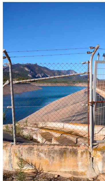
En esta imagen se visualiza la obra de entrada (a demoler) con las aguas procedentes del sondeo, el vallado perimetral (a demoler) y una puerta de acceso (a demoler).
