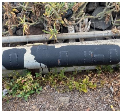
Imagen 5. Detalle de tramo en mal estado.
