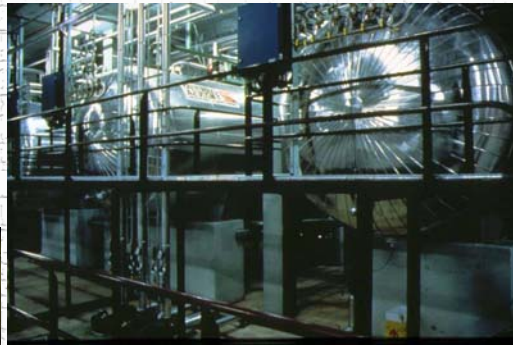
Tratamiento de efluentes
