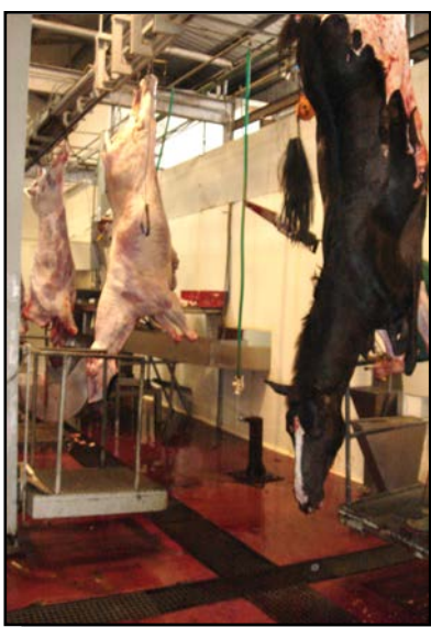
Ilustración 14. Detalle de la altura de la cadena de faenado.
