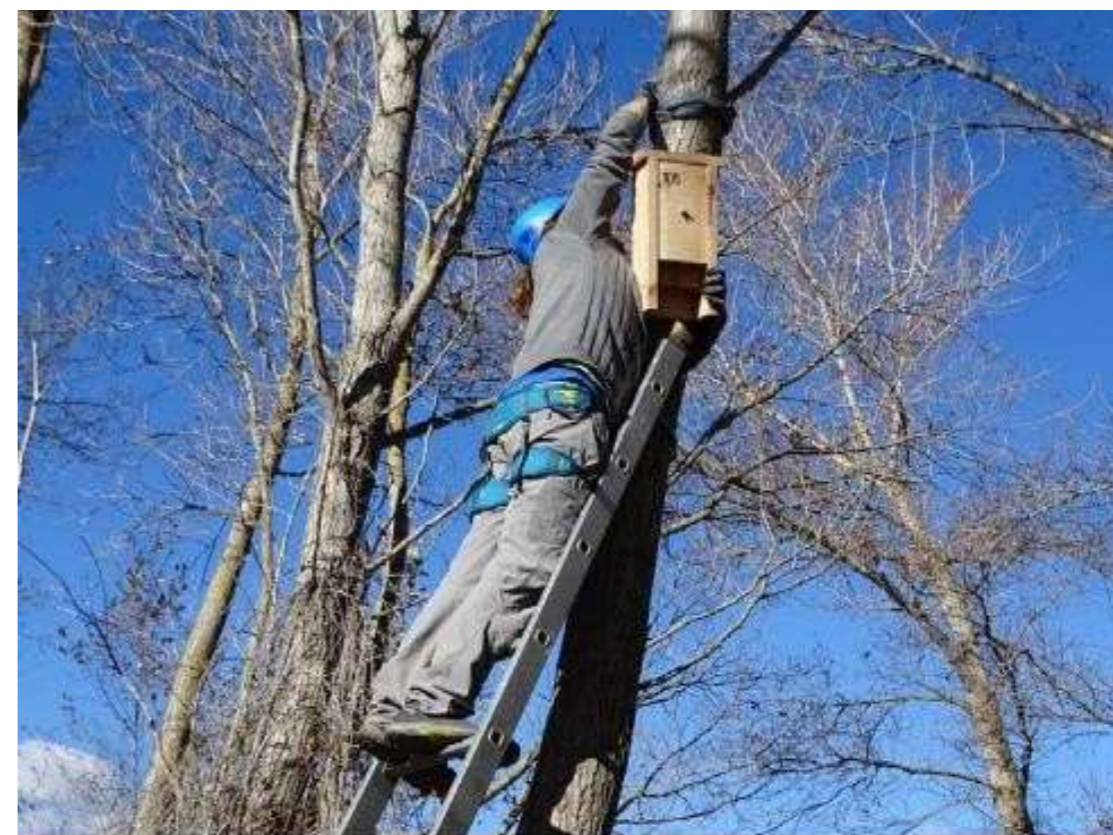
Imagen 69. Instalación de refugio para murciélagos. Obsérvese como el acceso está abierto en la base del refugio. Fuente: ANSE
