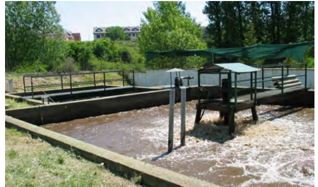
Imagen 1: aplicación de sistema de Nitrificación - desnitrificación.
