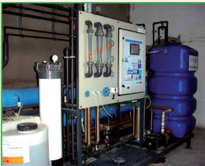
Planta de tratamiento de agua
