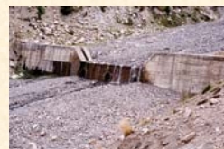
Dique en el Torrente de Senet completamente aterrado. Obra 1959-62. Alta Ribagorça. Vilaller. Lleida. 1984. José López Quintanilla, Alvaro Picardo y Sabas Yagüe.
