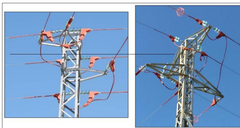
Ilustración 283: Medios antielectrocución en los apoyos de los tendidos eléctricos.
