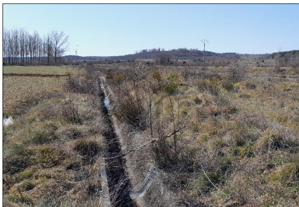
Ilustración 19: Acequia de la infraestructura de riego actual.
