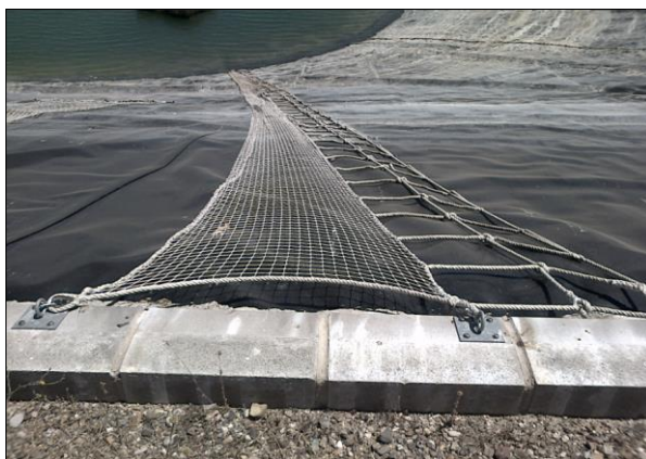
Ilustración 280: Escalera y malla para facilitar la salida de las balsas a animales y personas.
