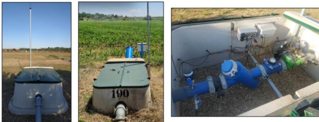
Ilustración 15: Ejemplos de arquetas de hidrante y de los componentes instalados en su interior.
