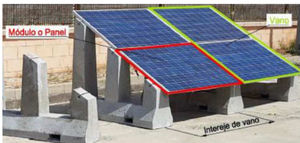
Ilustración 19: Soporte de Hormigón prefabricado
